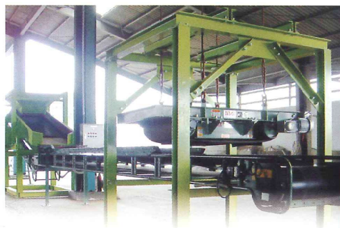
混合廃棄物手選別ラインの前処理（土砂抜き）設備
