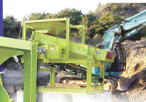
解体発生残土からの異物除去設備
