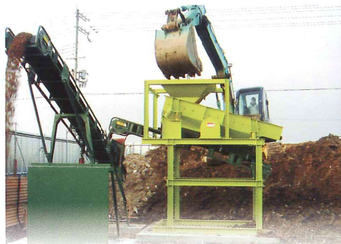
解体発生残土からの異物除去設備
