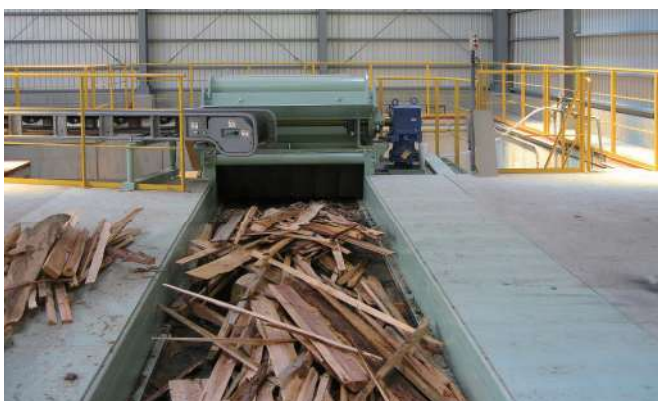
● 投入コンベヤ
